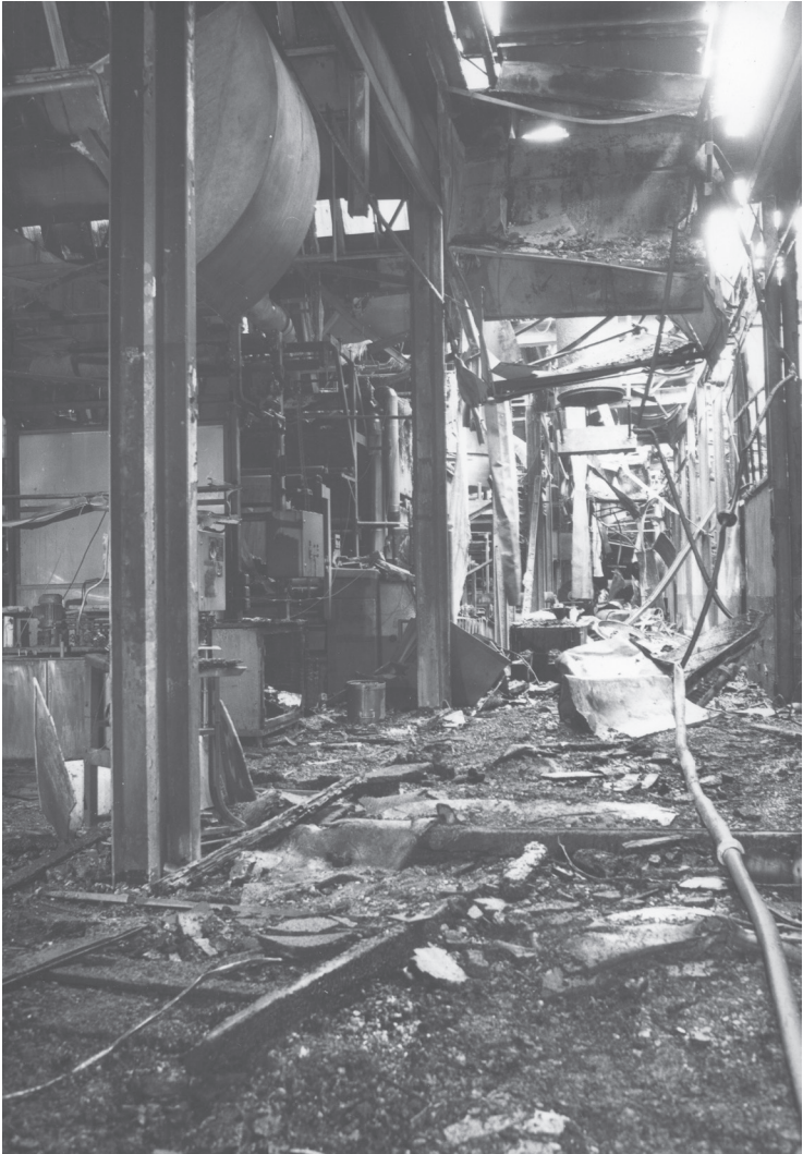
Nach dem Brand in einer Werkhalle der Stoffel AG in Netstal, 6. März 1979: Brandruine Gewerkschaft Bau und Industrie Photograph, F_5031-Fb-0516 Labor Netstal, 1979
