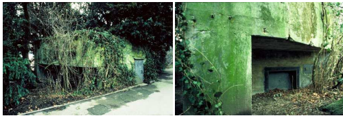
Der Zugang auf der Westseite liegt direkt beim Fussgängerbereich durch das Arboretum. Rechterhand eine Nahaufnahme der Schiess- und Beobachterscharte mit Flankenschütz. Bilder: Denkmalpflege Kanton Zürich
