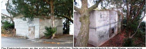
Die Elektroleitungen an der südlichen und östlichen Seite wurden nachträglich für den Mieter angebracht.
